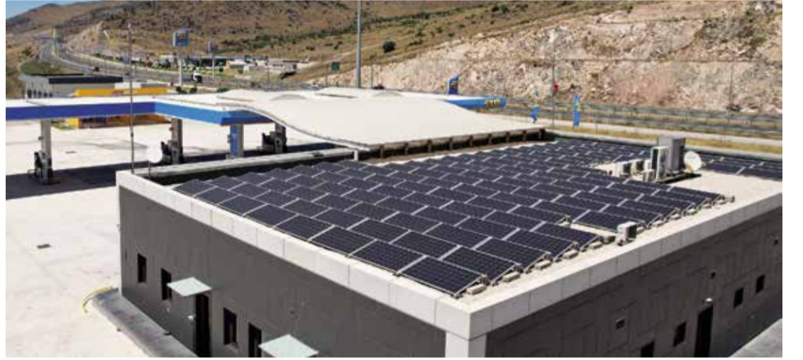
OPET İKA Foça İstasyonları'nda bulunan GES (Güneş Enerjisi Sistemi) panelleri
